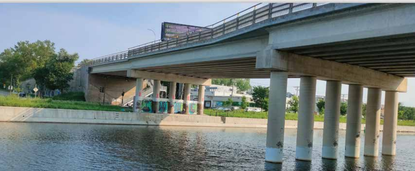
Nouveau viaduc Angrignon sur le canal Lachine et la rue Saint-Patrick, juillet 2023
